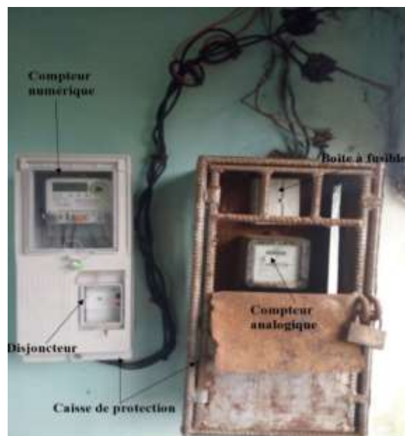
Photo 1. Les équipements de gestion électrique en « amont » dans la mini-cité « Steve Biko » (Source : Enquêtes de terrain par Eneckdem, 2021)
